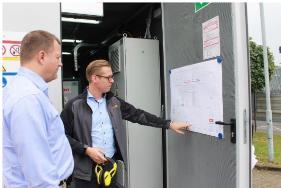
Sven Hennemann, Manager Energie- und Produktionstechnik erklärt Geschäftsführer Thomas Prangemeier die genaue Funktionsweise des BHKW
